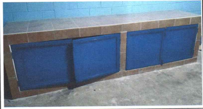
Foto 8: Estructura de soporte de madera deteoreada
